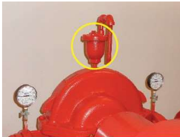
Gambar 8 — Air release valve terpasang pada bagian atas casing pompa (lingkaran kuning), berdampingan dengan pressure gauge sisi hisap dan pelepasan.
