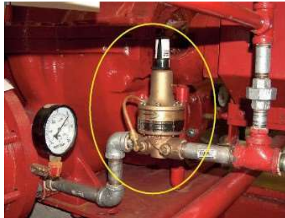
Gambar 9 — Casing/circulation relief valve (lingkaran kuning) yang berfungsi mengalirkan sirkulasi minimum untuk mencegah overheating pompa saat kondisi zero-flow.
